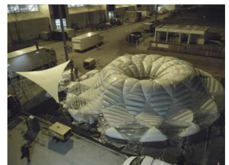
Wegen ungeplanter Leckagen am Prototypen musste das nötige Luftvolumen über Kompressoren bereit gestellt werden (Foto: Meeß-Olsohn)
